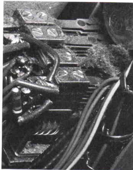
Trafikledaren tappade radarbilden! Orsak: Damm och fibrer på omkopplare och reläer störde funktionen. Foto: R Hedgren F17
